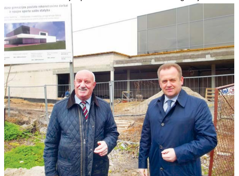
Seimo narys Artūras Skardžius (dešinėje) - Vydūno gimnazijos sporto salės statybvietėje. Prasidėjus statybos darbams, jis 2014 metais pasirašė laišką ateities kartoms, kuris buvo įdėtas į kapsulę ir įbetonuotas. A. Skardžius su Šilutės rajono savivaldybės, gimnazijos ir statybininkų vadovais dažnai aptaria šio objekto statybos darbų eigą.
